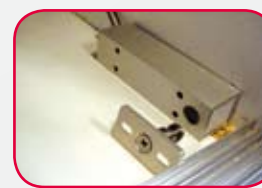
Protection des vitrines par verrous électromagnétiques
